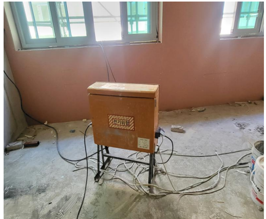
▲ 전기 분전함 현장 시건 조치
