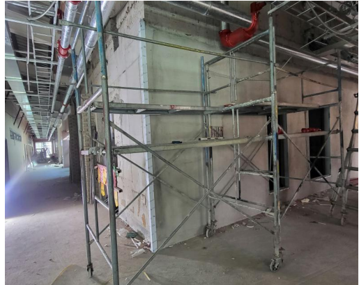
▲ 이동식 틀비계상부 안전난간대 설치 조치
