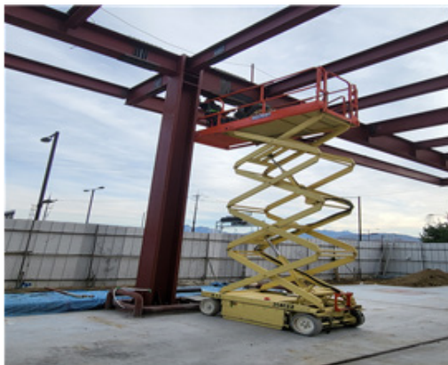
▲ 시저 고소작업대위 작업중 안전걸이 미설치
