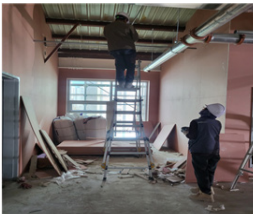
▲ 사다리 작업 중 아웃트레거 미사용
