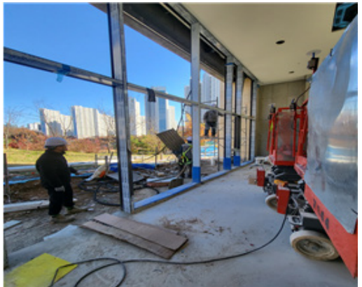
▲ 이동식 틀비계상부 안전난간대 설치 조치
