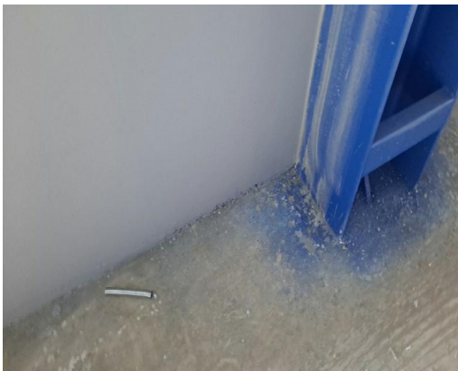
▲ 현장 내 화재 예방조치 요망 - 소화기 비치
