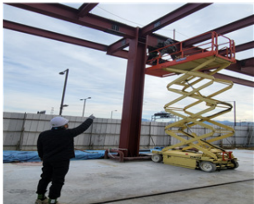
▲ 시저 고소작업대위 작업중 안전걸이 설치 조치
