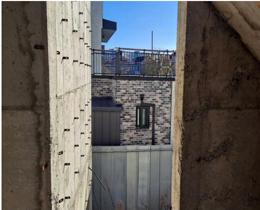
▲ 2층 계단참 창측 개구부 안전난간대 누락
