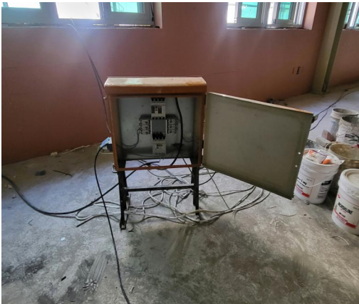
▲ 전기 분전함 개방상태 방치
